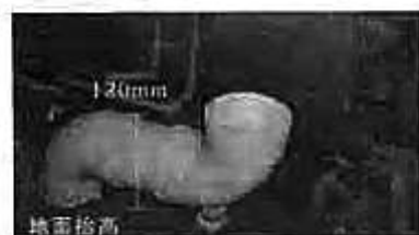
普通工艺 D110 管移位， 地面抬高施工困难
