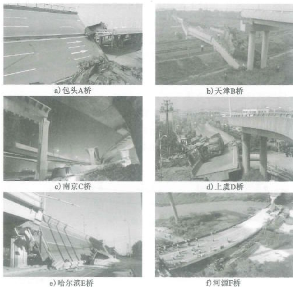
图 4.4-1 已倾覆桥梁的结构破坏情况
