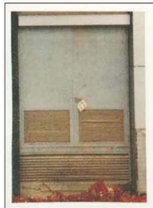
变压器室钢门及进风窗
