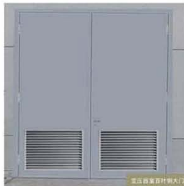
变配电室钢大门
