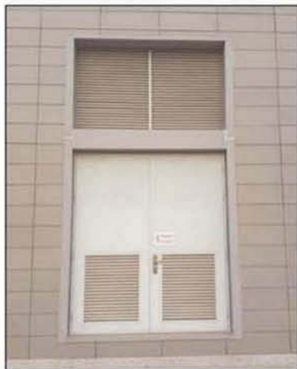
变压器室钢门及排风窗
