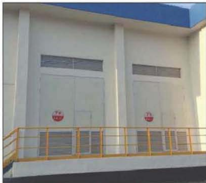
变压器室钢门及排风窗
