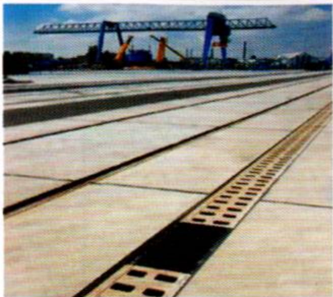
一体式排水沟
